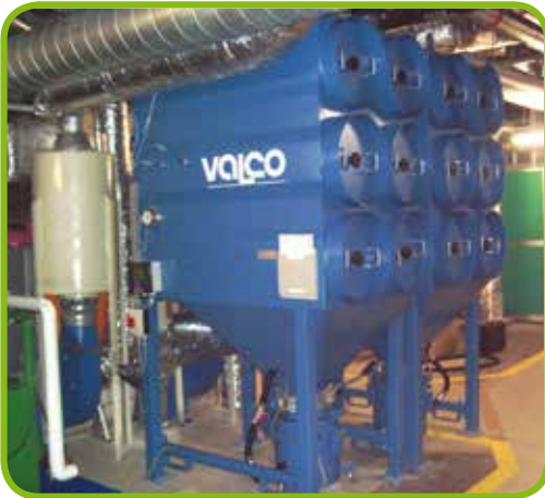
Patronenfilter für Tablettenindustrie, mit 60 m 2 Filterfläche (PTFE-Membrane) und 60 m 2 Sicherheitsnachfilter, Filteranlage innerhalb für ATEX Zone 20
