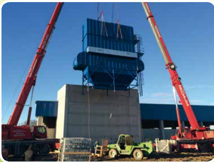
Schlauchfilteranlage für 175.000 m 3 /h, 36 t Anlagengewicht.
