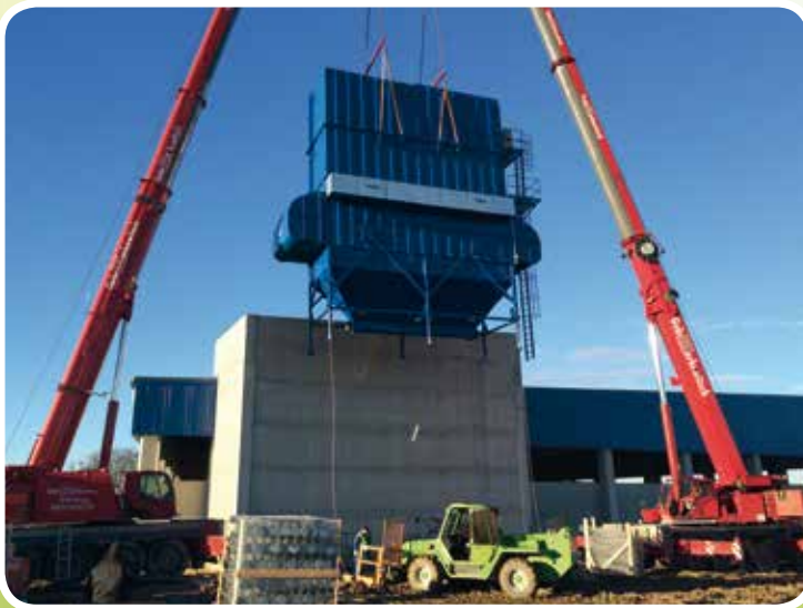
Schlauchfilteranlage für 175.000 m 3 /h, 36 t Anlagengewicht.
